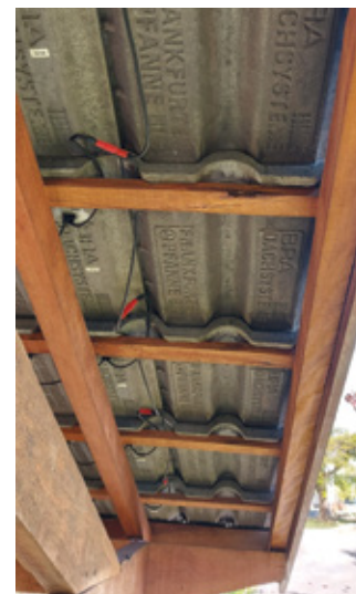
Conexão Paralelo Positivo – Lado direito do telhado (Vista Frontal Inferior)
